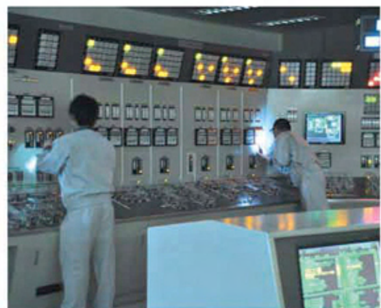
●全交流電源喪失時の対応訓練
