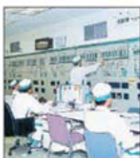
●中央制御室の様子
